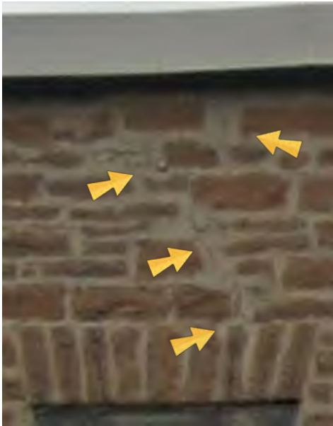
Fig 9a. Crack at 3E2-RE2 before...
